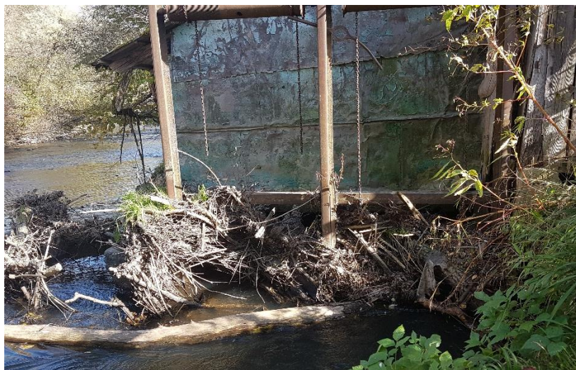
Slika 39: Odvodni kanal v strugo zadelan s plavjem
