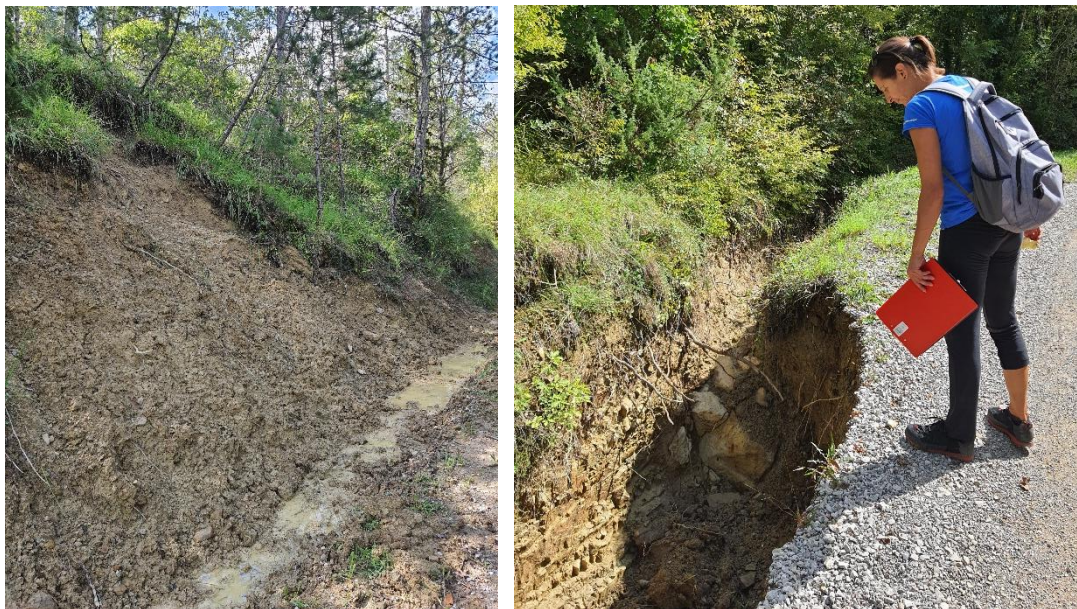
Slika 17: Posuta brežina na delu rastišča Marchesettijeve smetlike (levo; del zemljine so zaradi zagotavljanja prehodnosti ceste že odstranili) ter močno poglobljen obcestni jarek na delu rastišča.
