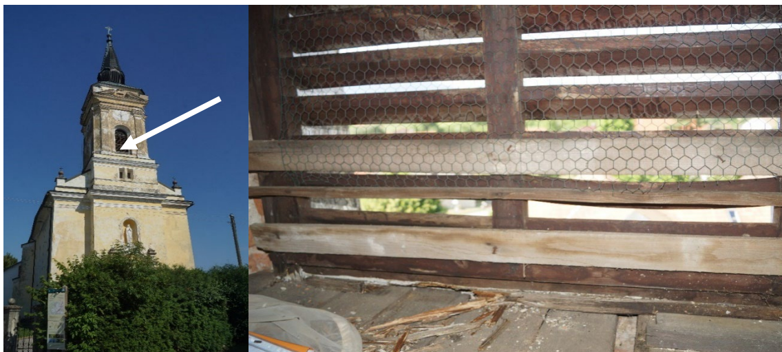
Slika 8: Mesto in fotografija špranje na zamreženi polkni na prednjem delu cerkve v Kapelah, ki se mora med in po obnovi ohraniti.
