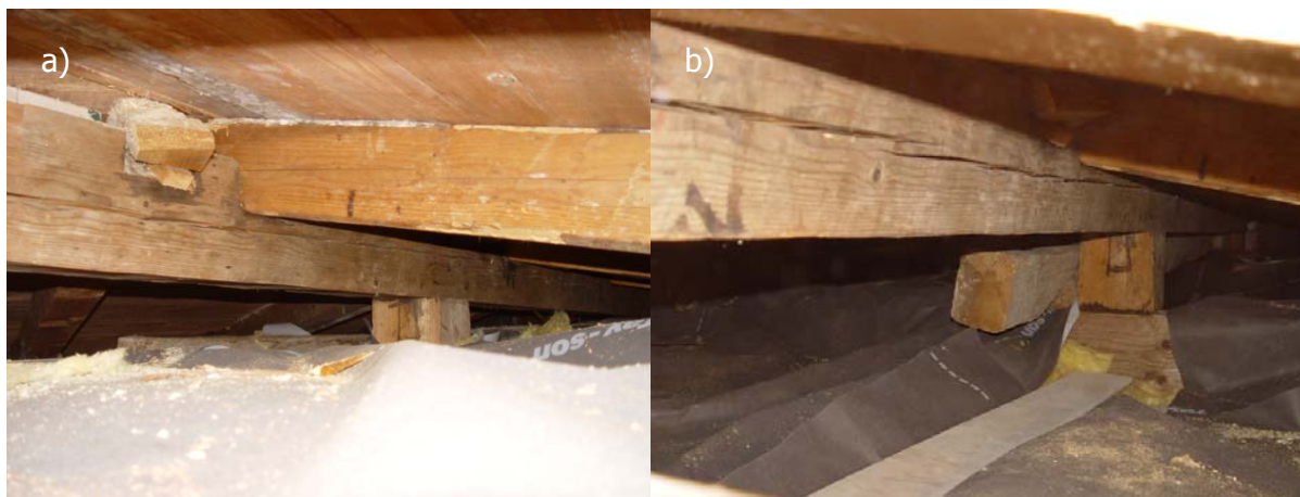
Slika 68. Podstrešje vzhodnega trakta grad Snežnik a) pred in b) po varstvenih ukrepih.
